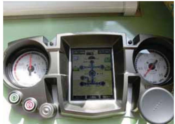
放水ポンプ操作盤・液晶パネル付き。
